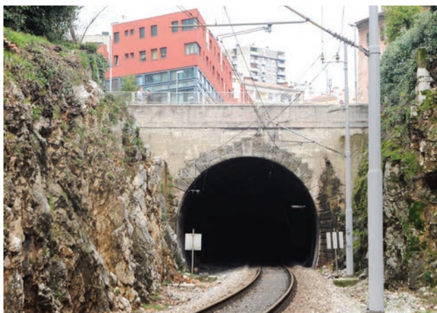
Zapadni portal tunela Kalvarija koji je trebalo ojačati
