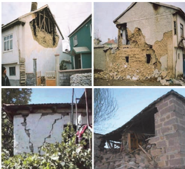
Slika 1. Štete na zidanim građevinama
