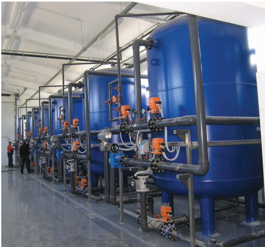
Suvremena oprema u novoj strojarnici i filtrirnici
