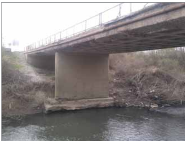
Slika 4. Upornjaci i stupovi (Most 1) u vrijeme pregleda, s vidljivim znakovima podlokavanja
