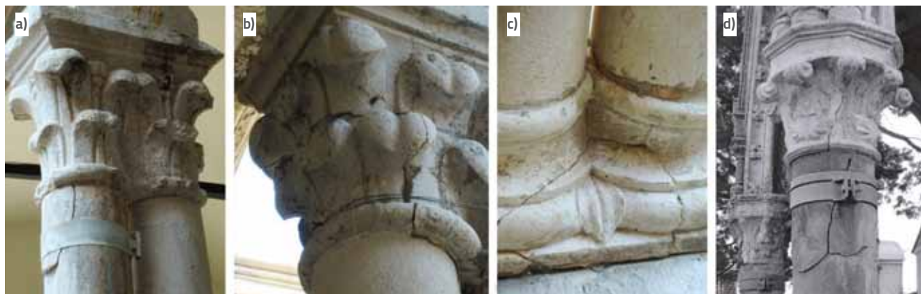
Slika 1. Pukotine na tradicijskim kamenim stupovima s ostacima prethodnih sanacija
