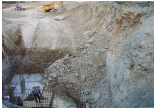
Slika 2. Urušavanje pokosa građevne jame iskopane u laporu (Split, lokacija: Trstenik)
