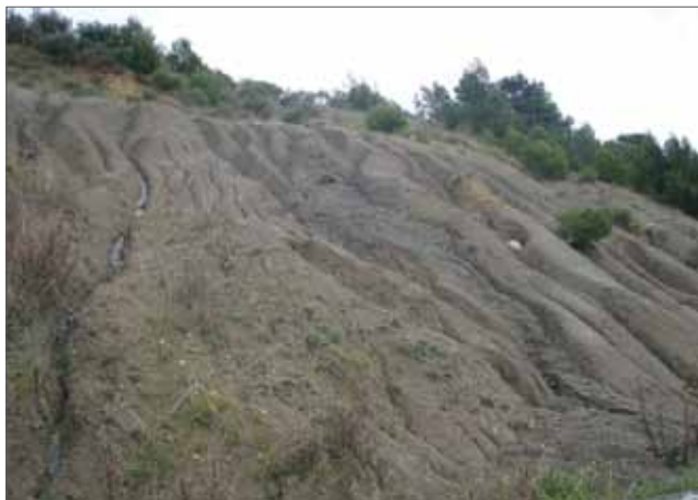
Slika 1. Degradacije lapora na površini kosine uz Jadransku magistralu (mjesto Podstrana)
