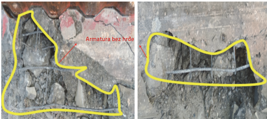
Slika 10. Korozija čeličnih šipki
