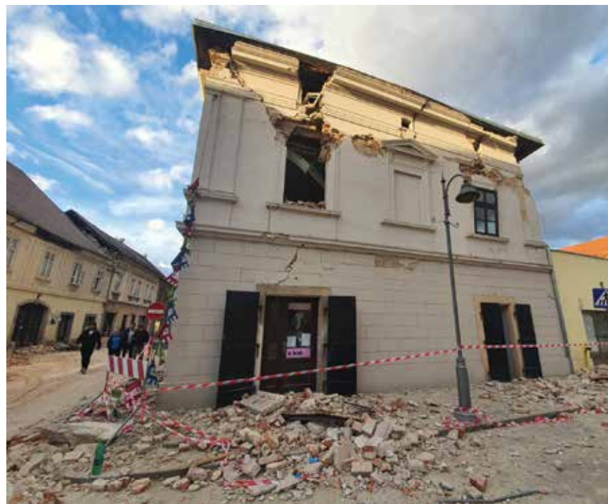
Dugoročna strategija dodatno će isticati pitanje rizika od pojačane potresne aktivnosti, a uključivanje troškova sanacije zgrada oštećenih u potresu predviđeno je unutar politika i mjera za nacionalni fond zgrada
