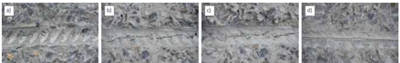
Slika 8. Oštećenja na unutarnjoj površini spoja nakon mikrovalnog zračenja: a) 0 W; b) 1000 W; c) 3000 W; d) 5000 W
