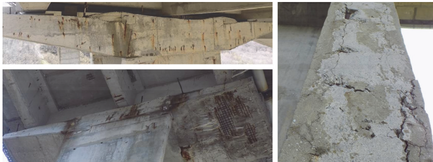
Slika 11. Oštećenja na nosivim dijelovima vijadukta Bukovo zbog korozije i dotrajavanja betona
