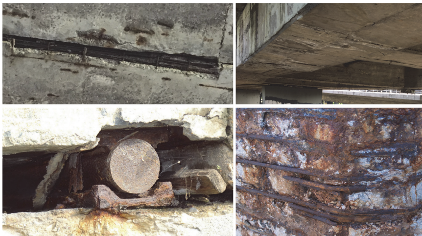
Slika 12. Oštećenja na nosivim dijelovima na mostovima u gradu Zagrebu zbog korozije
