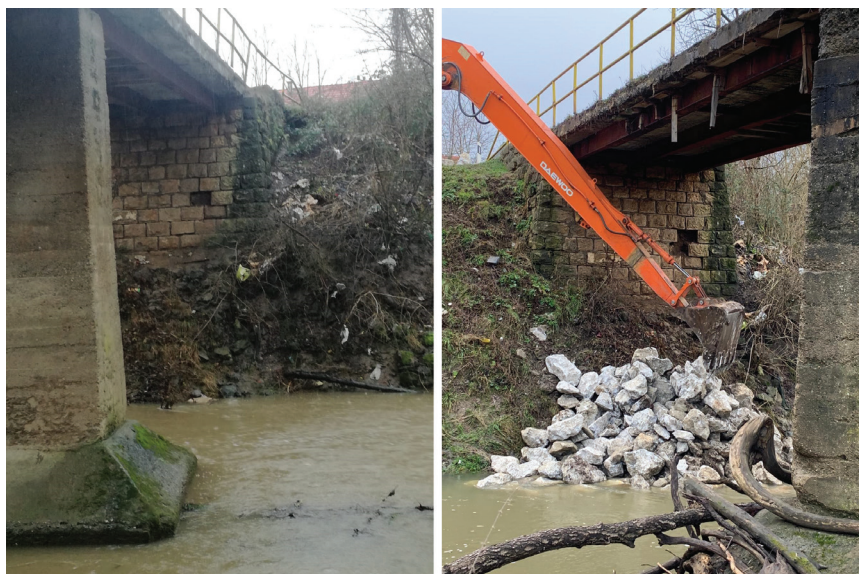
Slika 8. Most oštećen u potresu: oštećenja upornjaka pojačana djelovanjem potresa (lijevo) te interventna sanacija radi uspostavljanja sigurnosti prometovanja mostom (desno)
