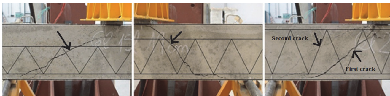
Slika 9. Pojava posmičnih pukotina na uzorcima iz serije 1, s pojedinačnim visinama rešetaka od 15, 19, i 24 cm
