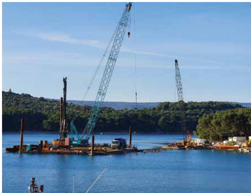
Zbog koronavirusa i ograničenja kretanja radnici imaju problema s dolaskom na gradilišta, posebno na otocima
