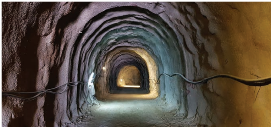
Inekcijsko drenažna galerija
