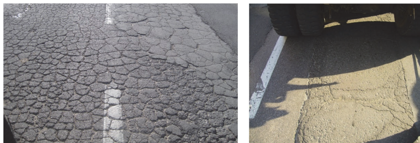
Slika 7. Mrežaste aligator-pukotine visokog intenziteta (lijeva slika) i zakrpe srednjeg intenziteta (desna slika)
