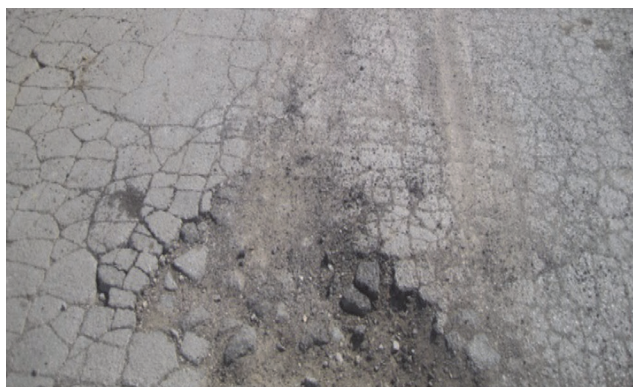
Slika 8. Udarne rupe visokog intenziteta, gdje su u okolini zastupljene mrežaste aligator-pukotine
