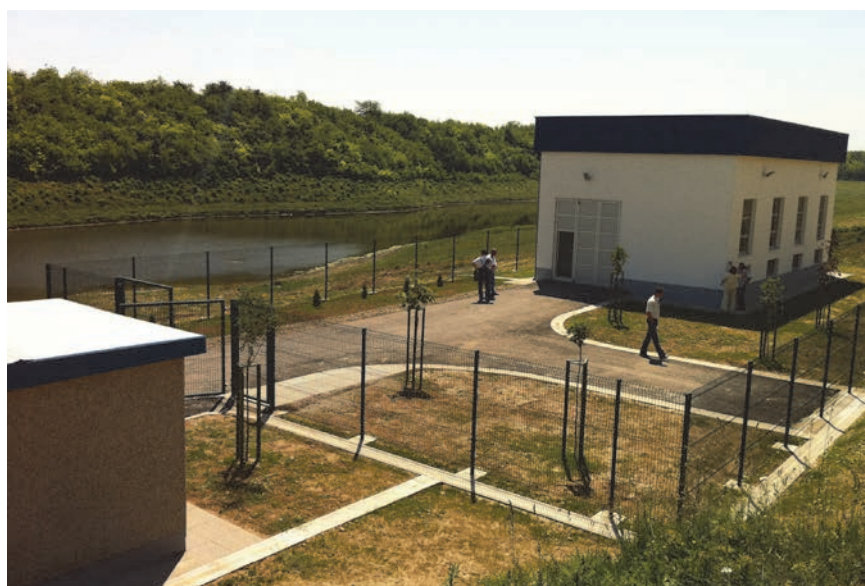
Crpna stanica Sustava navodnjavanja Opatovac
