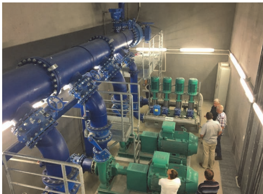
Crpna stanica Sustava navodnjavanja Kapinci – Vaška
