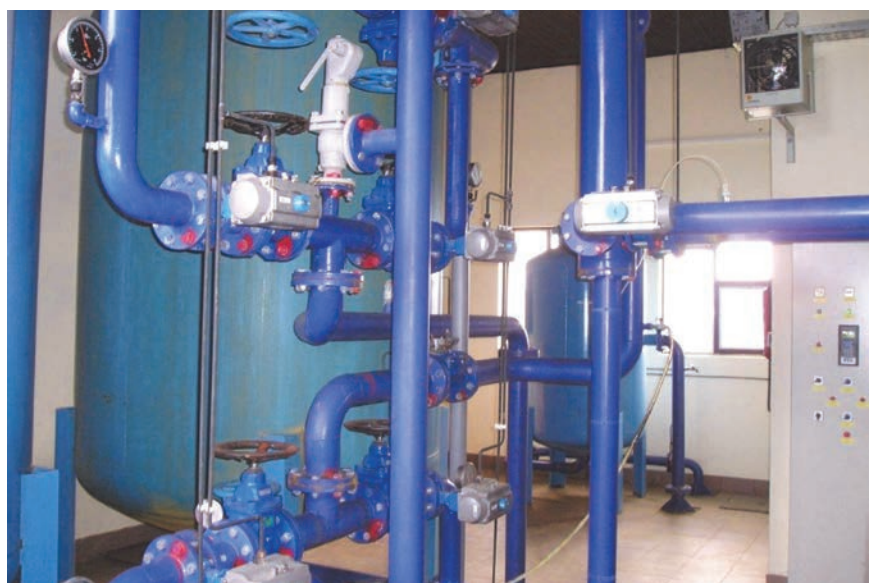
Dio opreme za kondicioniranje pitke vode u Đakovu
