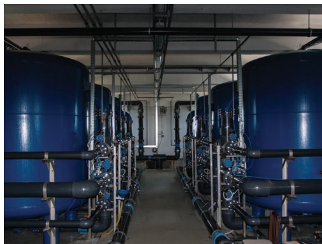
Suvremena oprema uređaja za preradu pitke vode na izvorištu Velimirovac
