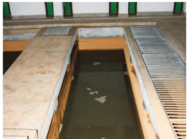
Stari pogon filtracije u crpilištu Medinci
