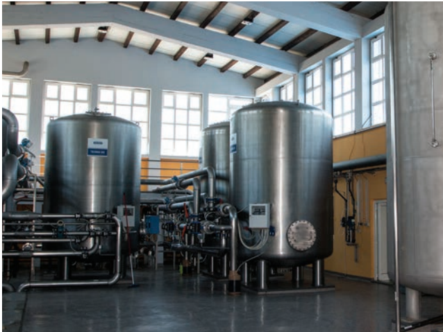
Unutrašnjost crpilišta Donji Miholjac
