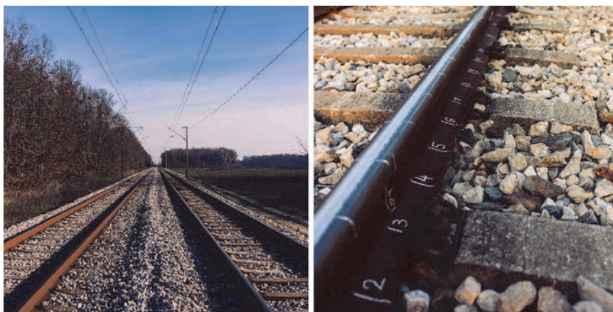
Slika 8. Dvokolosiječna željeznička pruga Vrpolje - Ivankovo (km. položaj: 183+900) (lijevo) i ugrađena tračnica na istoj dionici (desno)
