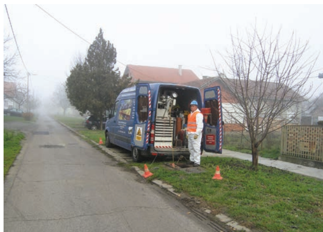
Vozilo za inspekciju kanalizacijskog voda u Ulici Izidora Kršnjavoga
