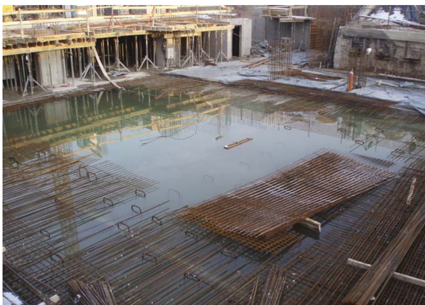
Pojava podzemne vode na gradilištu
