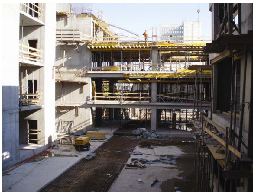
Radovi na nadzemnom dijelu građevine (u sredini široka radna reška u temeljnoj ploči)
