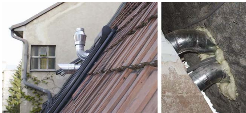
Slika 8. Detalj odvoda i dovoda zraka na krovu
