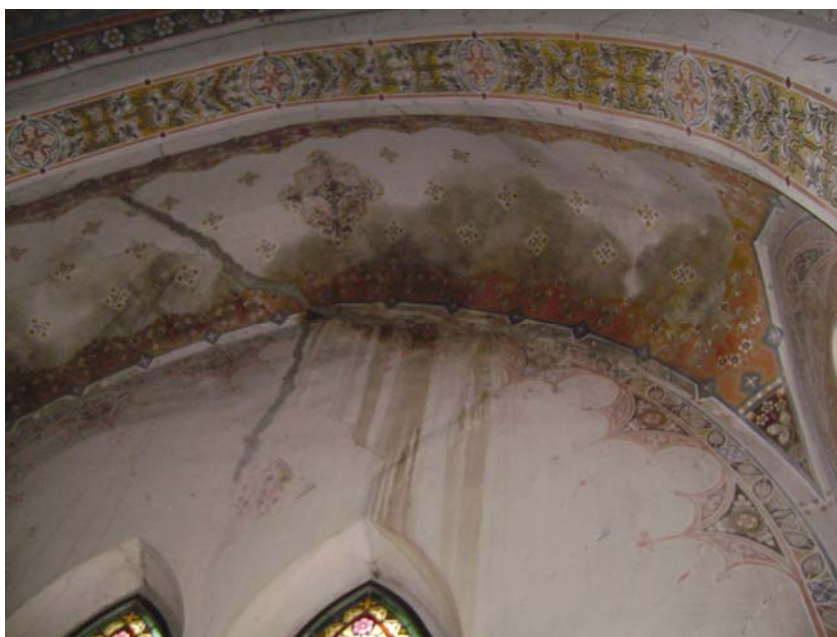
Oštećenja svoda nastala od prodora vlage
