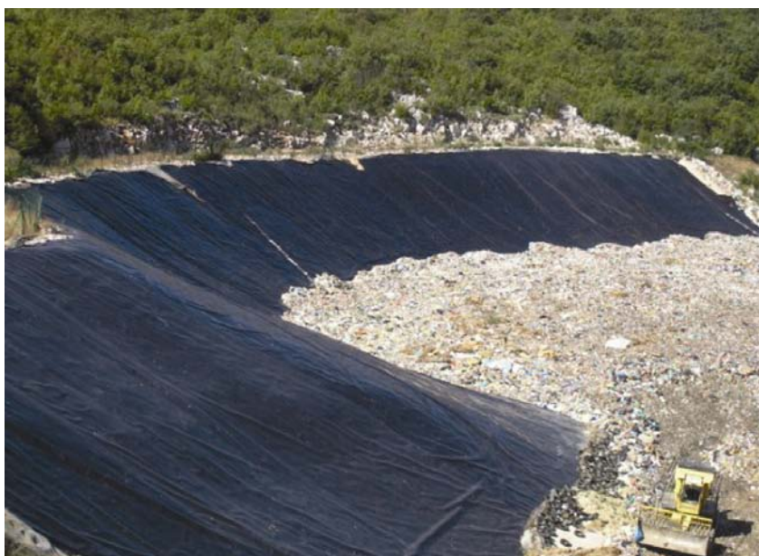
Zatrpavanje otpada na odlagalištu Grabovica
