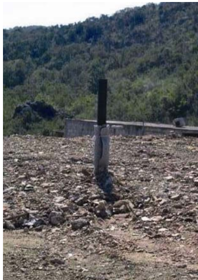
Cijev za otplinjavanje na odlagalištu Grabovica
