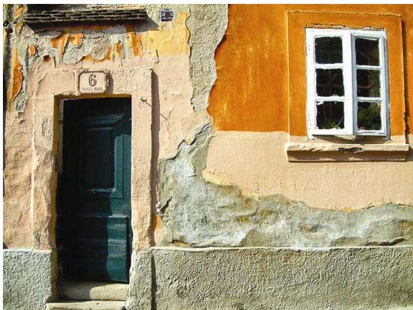
Pročelje uništeno kapilarnom vlagom
