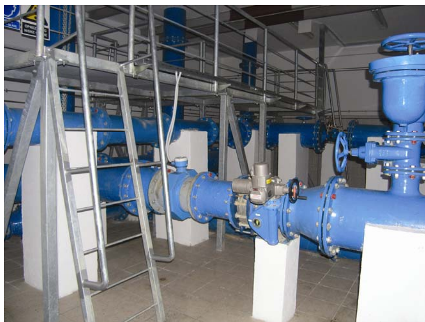
Oprema u vodospremniku Banov Stol
